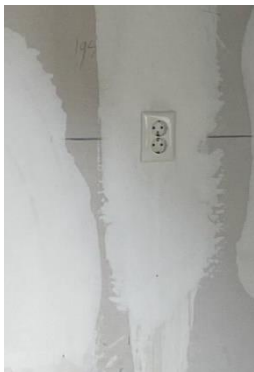
Voorbeeld van een behangklare muur. (standaard worden wandcontactdozen verticaal aangebracht)
